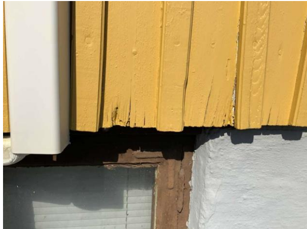
Bild 8: Utvändigt, Fasad, Färgsläpp och rötskador i panel noterades vid balkongen Torrspäckor i träpanel ovan dörr balkong se riskanalysen
