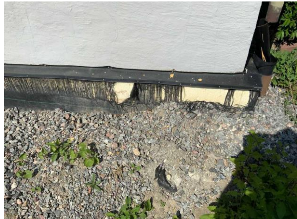
Bild 4: Utvändigt, Mark, Dräneringens topplist är synlig ovan mark. Topplisten ej tät mot platonmatta i överkant. Duk synlig på baksidan ej utförd med fiberduk. Skadad fiberduk fi...
