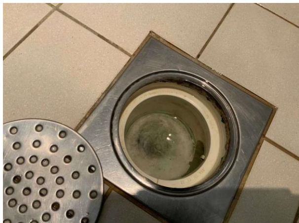
Bild 13: Invändigt, Övervåning, Duschrum, Äldre våtrum se riskanalysen Klämring saknas i golvbrunnen Sk bomgolv noterades (ihåligt ljud när man knackar på plattorna)
