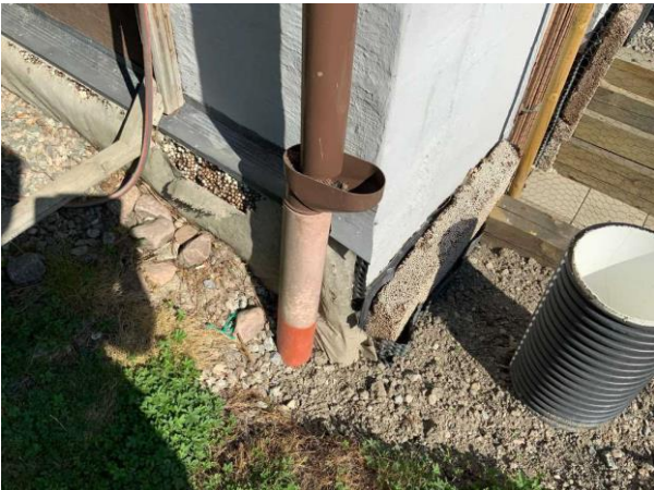
Bild 3: Utvändigt, Mark, Dräneringens topplist är synlig ovan mark. Topplisten ej tät mot platonmatta i överkant. Duk synlig på baksidan ej utförd med fiberduk. Skadad fiberduk fi...
