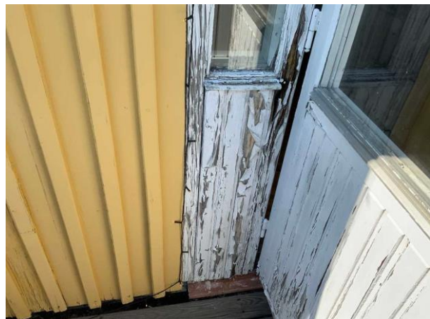
Bild 6: Utvändigt, Fasad, Färgsläpp och rötskador i panel noterades vid balkongen. Torrspäckor i träpanel ovan dörr balkong se riskanalysen.
