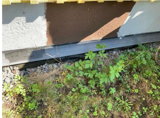
Bild 2: Utvändigt, Mark, Dräneringens topplist är synlig ovan mark. Topplisten ej tät mot platonmatta i överkant. Duk synlig på baksidan ej utförd med fiberduk. Skadad fiberduk fi...
