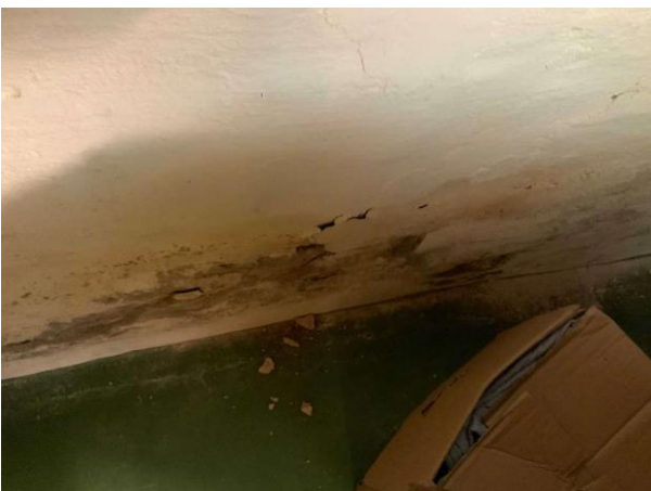
Bild 11: Invändigt, Källarplan, Förråd, Spår att det trängt in vatten noterades på träpanel mot ytterväggar Lös puts mot murstock Fuktgenomslag i grundmurar Tejpade avloppsrör
