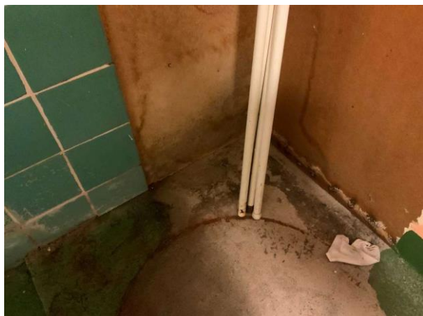
Bild 12: Invändigt, Källarplan, Tvättstuga, Utförd utan tätskikt på golv Äldre golvbrunn av gjutjärn Inklädda källarväggar med fuktmärken se fortsatt teknisk utredning
