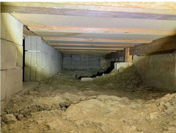
Bild 5: Utvändigt, Krypgrund, Fuktavvisande plastfolie saknas över grundens botten. Sprickor i grundmurar noterades. Fläck under bjälklagsskiva (äldre). En bjälklagsskiva är...
