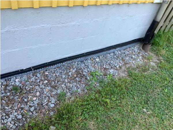
Bild 1: Utvändigt, Mark, Dräneringens topplist är synlig ovan mark. Topplisten ej tät mot platonmatta i överkant. Duk synlig på baksidan ej utförd med fiberduk. Skadad fiberduk fi...
