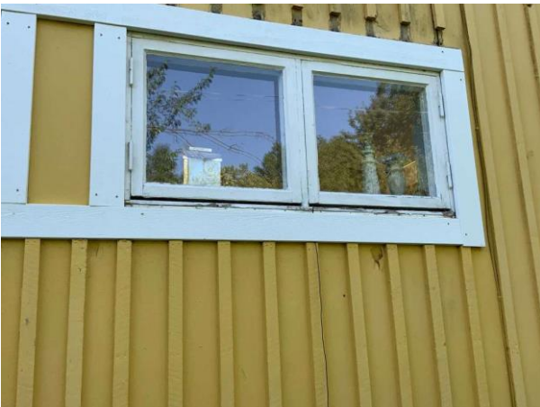
Bild 9: Utvändigt, Fönster, Uppvik saknas på fönsterbleckens ändar och fönsterbleck saknas på gavel Färgsläpp noterades på fönsterbågar
