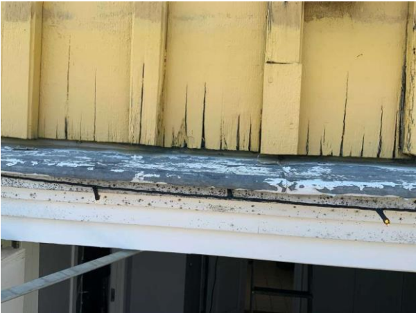
Bild 7: Utvändigt, Fasad, Färgsläpp och rötskador i panel noterades vid balkongen Torrspäckor i träpanel ovan dörr balkong se riskanalysen
