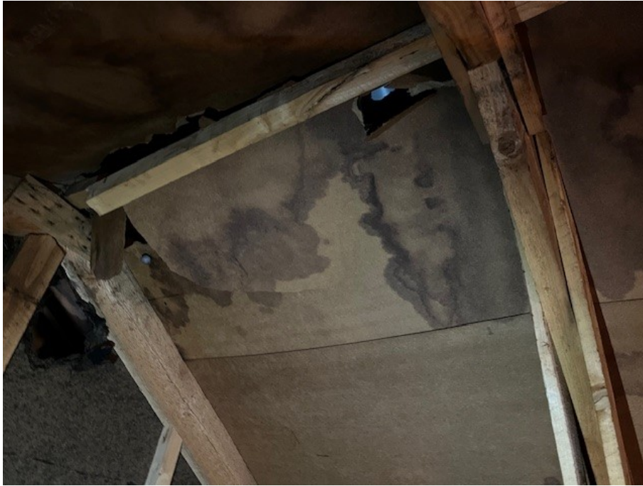
Skador/otätheter samt fuktfläckar i det ursprungliga underlagstaket av masonit.
